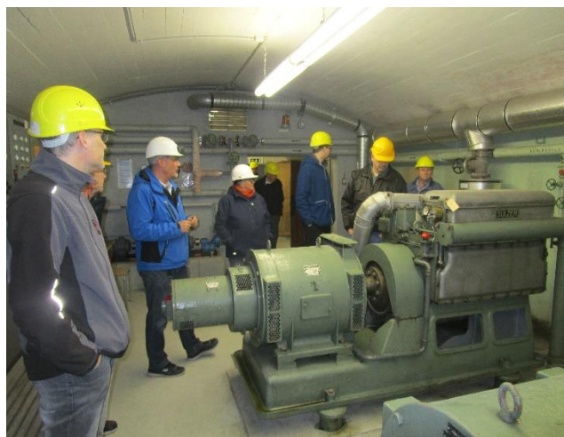
Drei Sulzer Dieselmotoren für die Notstromanlage
