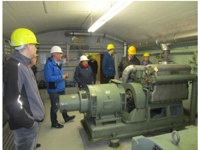
Drei Sulzer Dieselmotoren für die Notstromanlage
